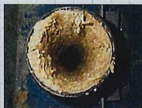
尿石付着による配管閉塞
